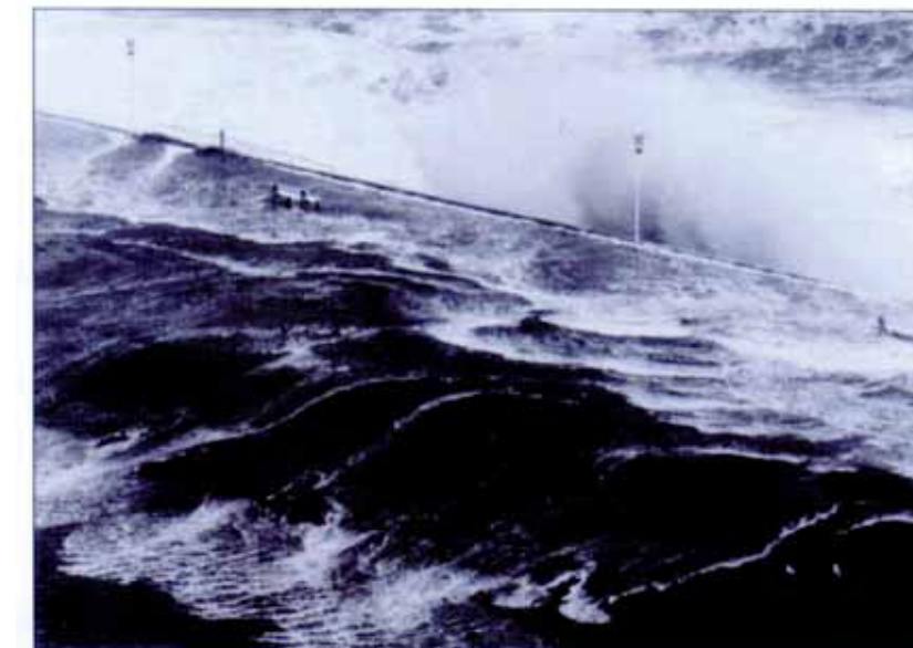
Abb. 4: Durch Wellenüberlauf am Deckwerk an der Kaiserwiese während der Sturmflut vom 03.01.1976 fließen erhebliche Mengen Wasser in die Stadt Norderney
